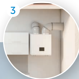
3 NANOCLIMA. Installation pour service de chauffage/rafraîchissement.
