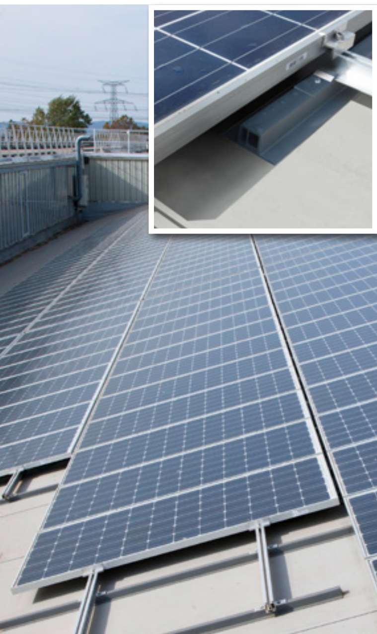
Bâtiment industriel Valéo – France 24 500 m 2 RENOIT ALKORPLAN F + profilés RENOIT ALKORSOLAR Crédits photos EDF ENR et Photec
